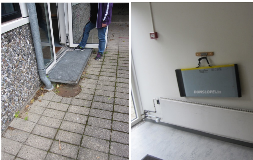
Nødudgang og transportabel rampe ved faglokaler i kælderplan
